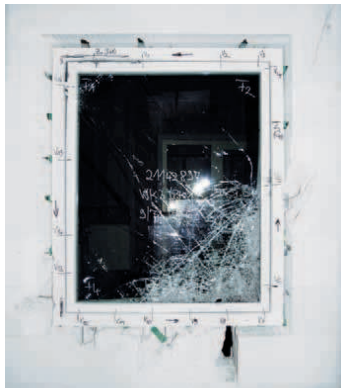
Bild 10: geprüftes Fensterelement und Porenbetonwand nach über 30 Minuten manueller Prüfung an verschiedenen Angriffsstellen
