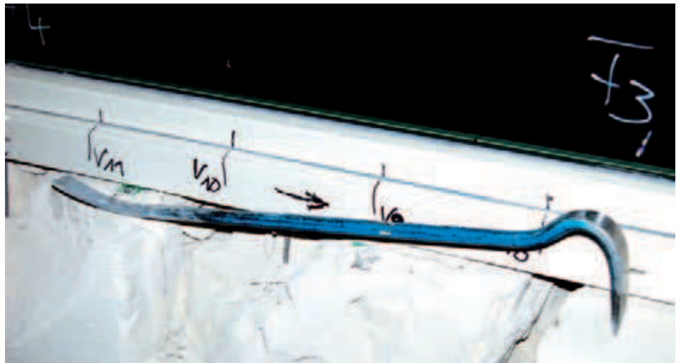
Bild 9: Versuch innerhalb von fünf Minuten mit dem Kuhfuß direkt durch die Wand zu brechen
