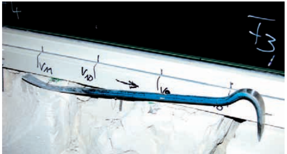
Bild 9: Versuch innerhalb von fünf Minuten mit dem Kuhfuß direkt durch die Wand zu brechen
