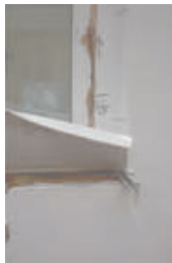
Bild 42. Mechanischer Angriff auf eine „normale“ Fensterbank aus Aluminium (Foto: Küenzlen)
