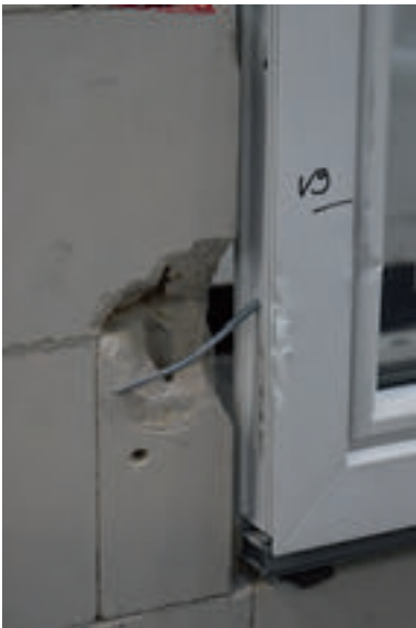
Bild 34. Beschädigung durch manuellen Einbruchversuch in der Klasse RC 2 mit Schraubendreher in Kalksandlochstein nach einer Prüfdauer von 65 Sekunden (Foto: Küenzlen)
