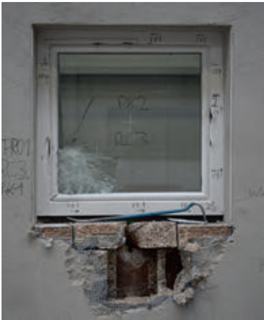
Bild 45. Beschädigung einer Wand aus Leichtbeton-Lochsteinen nach 5 Minuten Prüfdauer in der Klasse RC 3, wobei die oberste Steinreihe im Bereich der Brüstung mit Leichtbeton-Vollsteinen ausgeführt wurde (Foto: Küenzlen)
