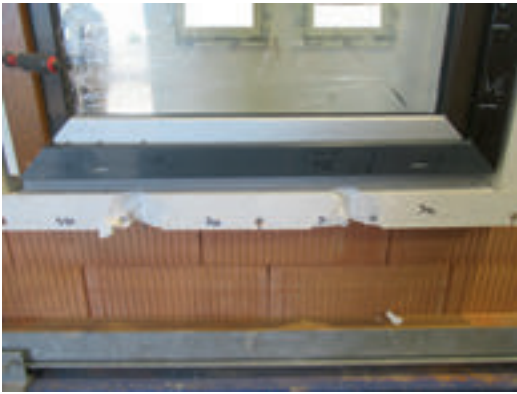
Bild 52. Schadensbild bei einem Randabstand des Befestigers zur Außenkante des System EPS von 55 mm bei einer Prüfdauer in der Klasse RC2 von rund 3 Minuten in der Klasse RC2 (Foto: ift Rosenheim, [27])
