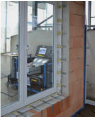
Bild 48. Montagesituation im Bereich der Brüstung und der Laibung mit Konsolen in einem Ziegelmauerwerk [32]
