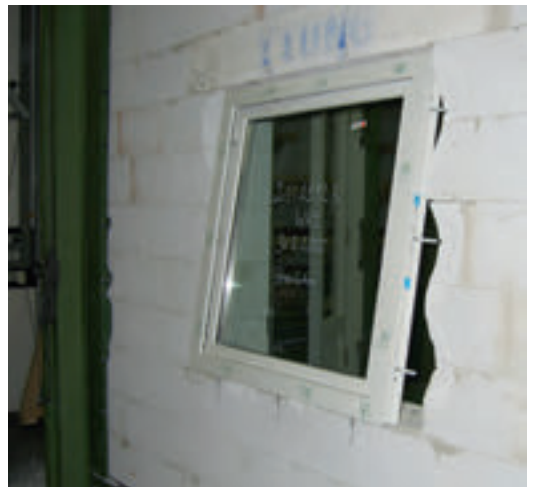
Bild 12. Aus dem Verankerungsgrund gerissenes Fensterelement bei zu geringem Randabstand in Mauerwerk aus Porenbetonsteinen (Foto: Küenzlen)
