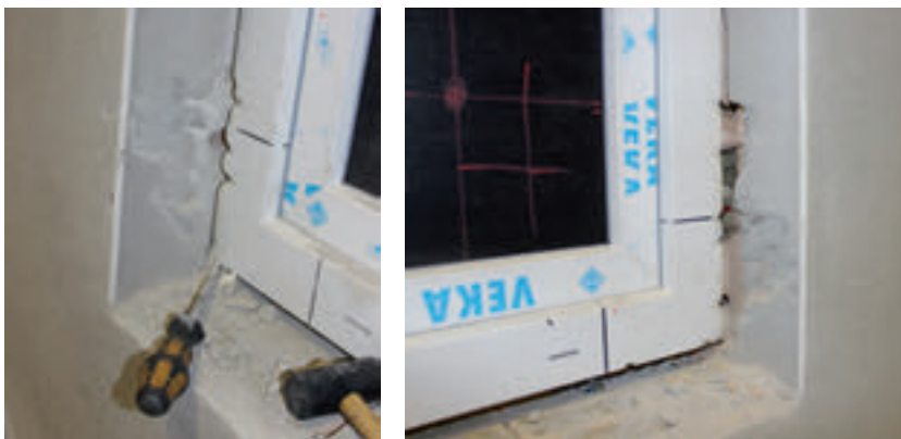
Bild 26. Beschädigungen nach mechanischem Angriff (Widerstandsklasse RC 2); a) linke Laibungsseite mit und b) rechte Laibungsseite ohne Armierungsputz mit Gewebeeinlage (Fotos: Dr. Meyer)
