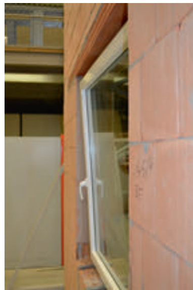
Bild 18. Auslenkung des Fensters bei statischer Prüflast von 3 kN ohne Befestigung oben und ohne seitliche Verklotzung [6]
