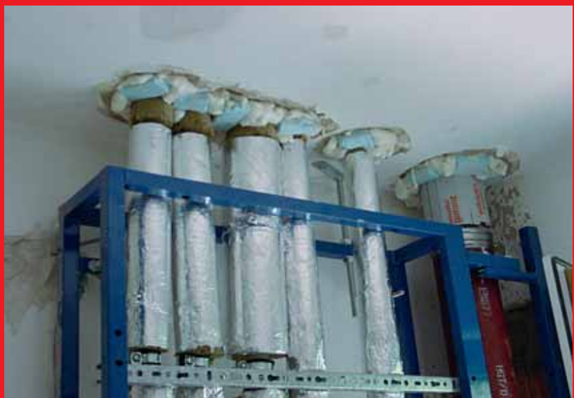
Umständliche Schalung mit Bauschaum. Gefahr durch eine zu geringe Überdeckung der Öffnung mit Mörtel.
