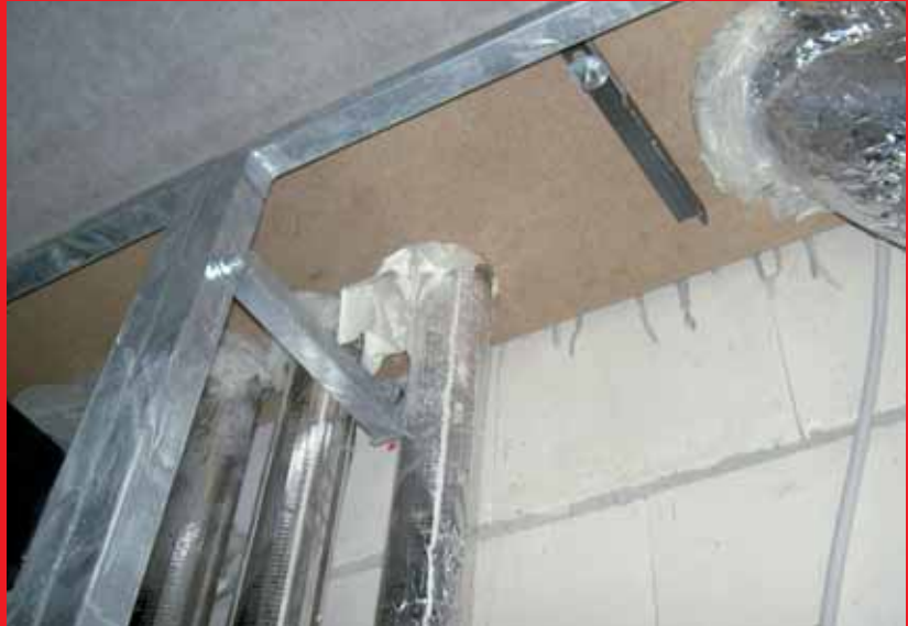
Brennbare Schalungen führen zu einer unerwünschten Erhöhung der Brandlast.
