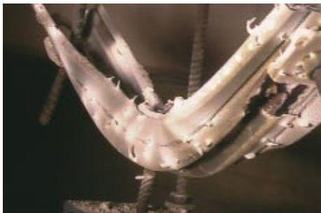
Bild 8: Schienensystem nach Brandbeanspruchung (deformierter Endquerschnitt).
