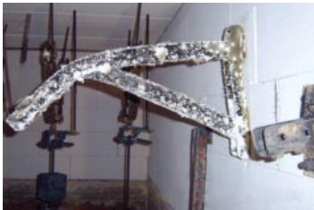
Bild 7: Tragkonsole nach Brandbeanspruchung.
