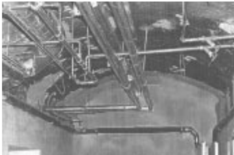
Bild 1 und 2: Einbausituation von Installationssystemen in der Praxis
